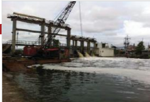
Wawang Pulo Pumping Station
